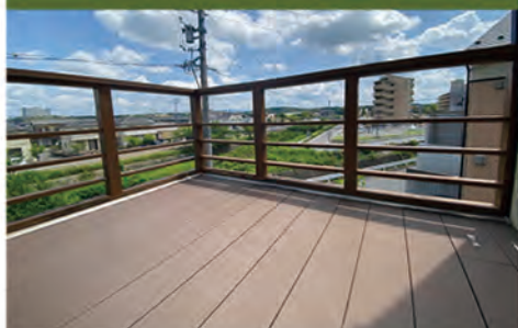
腐朽したウッドデッキの取替 参考価格 一か所 30万円～
